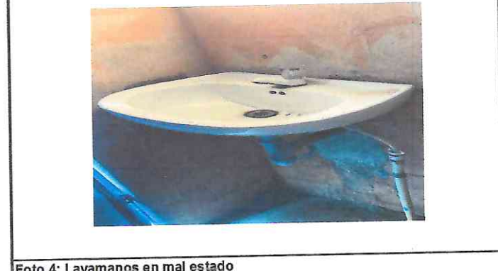
Foto 4: Lavamanos en mal estado
