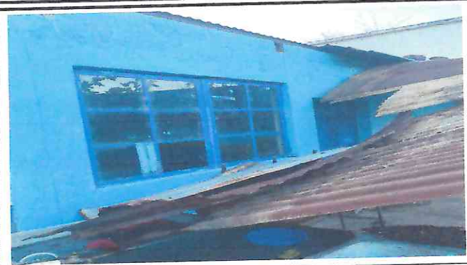
Foto 1: Techo destruido por los fuertes vientos
