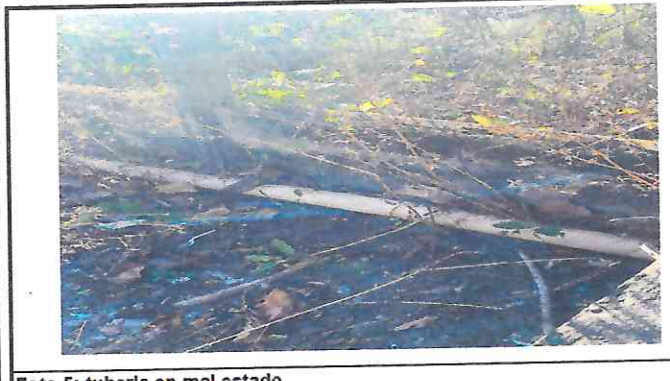
Foto 5: tubería en mal estado
