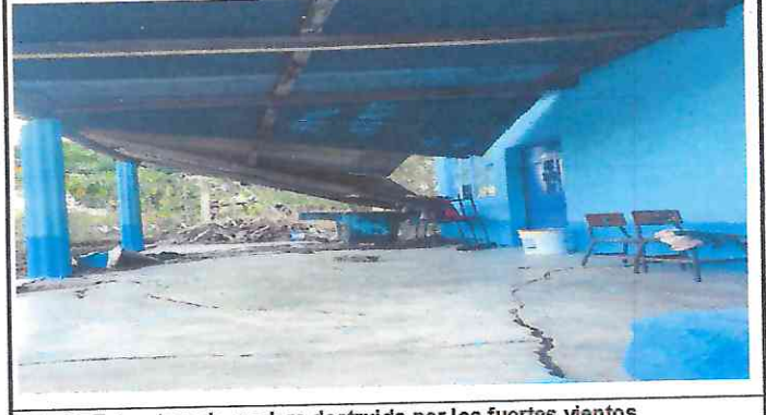
Foto 2: Estructura de madera destruida por los fuertes vientos
