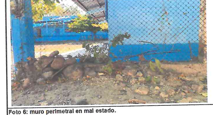
Foto 6: muro perimetral en mal estado.
