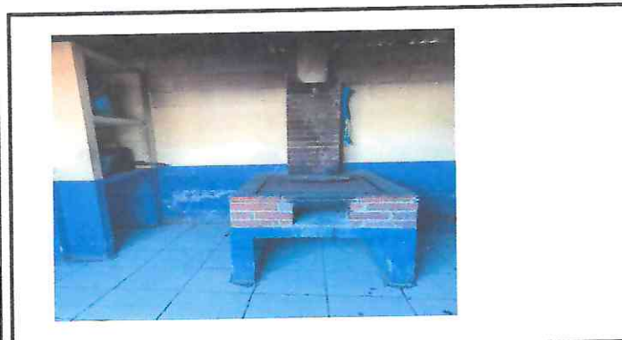
Foto 9: plancha deteriorada por falta de mantenimiento
